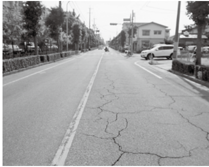
道路舗装のひび割れの様子
