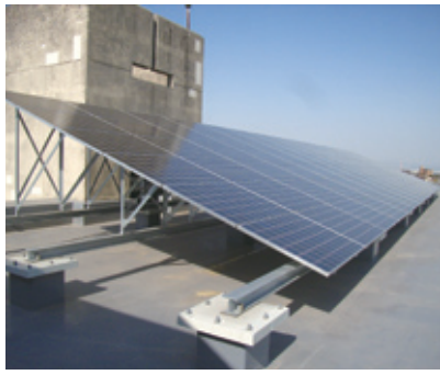
中学校に設置されている太陽光パネル
