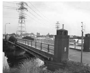
老朽化した刈谷橋
