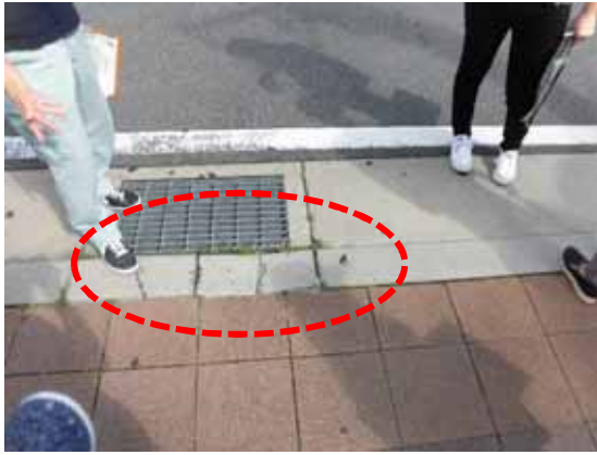
▲陥没した縁石
