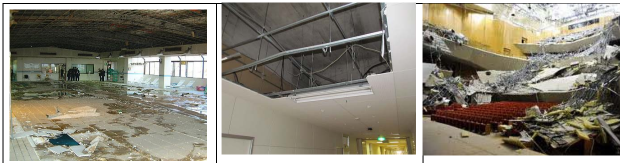
写真2.2 天井の落下被害事例
