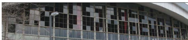
パテの硬化した嵌め殺し窓のガラスの破損
