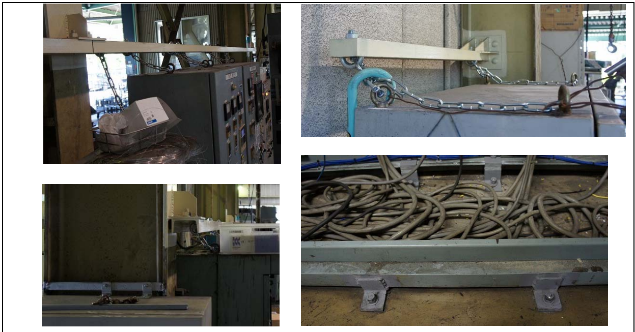
写真6.1 制御盤の転倒防止事例
