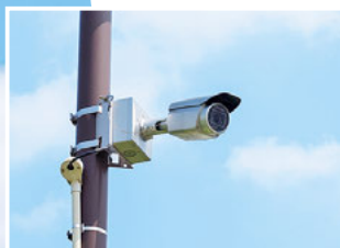
防犯カメラの設置
