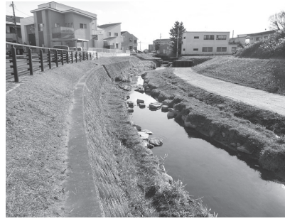
草刈り等を行い、河川環境の保全と堤防の安全を確保(折戸川)
