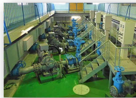
一ツ木配水場 配水ポンプ
