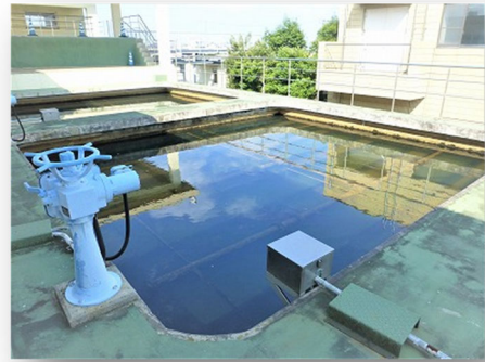
水源浄水場重力式ろ過池
