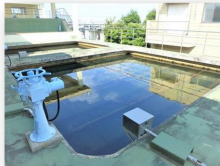
水源浄水場重力式ろ過池
