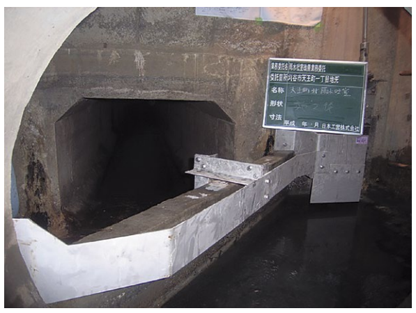
合流改善施設（渦流式水面制御装置）
