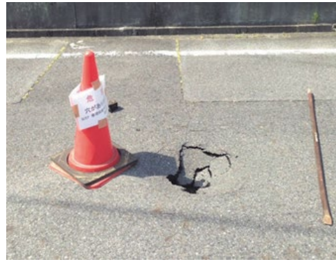
管きよの破損による道路陥没
