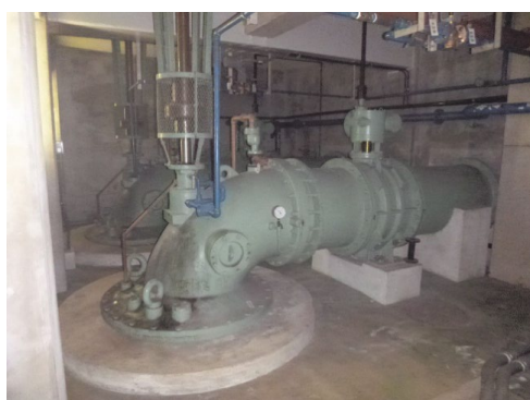
ポンプ設備 (エンジンポンプ)
