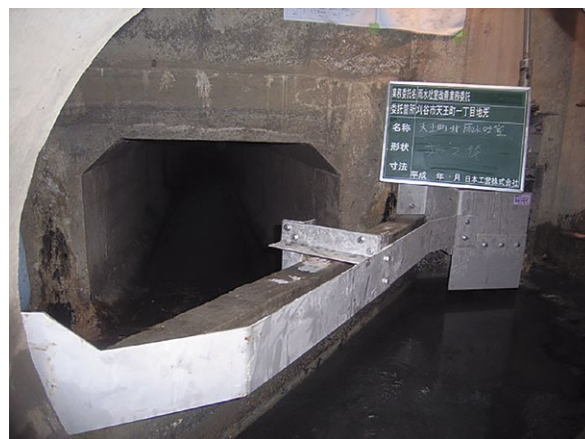
合流改善施設（渦流式水面制御装置）
