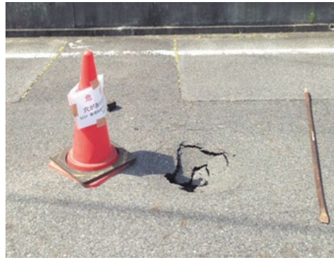
管きよの破損による道路陥没
