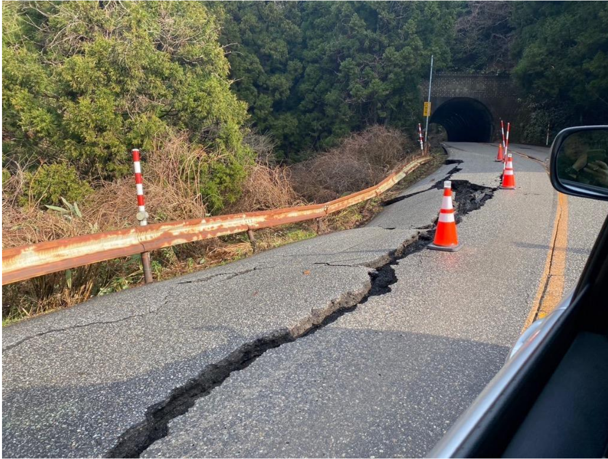
派遣先までの道中① （道路のひび割れ）
