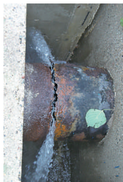
▲水道管の劣化による漏水
