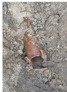
▲下水道管の劣化による破損
